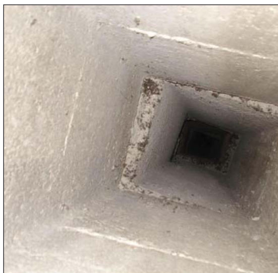
Rozszczelnienia na łączeniach kanału
